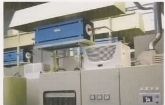
氨裂解炉及其控制装置 Ammonia Cracker Oven
