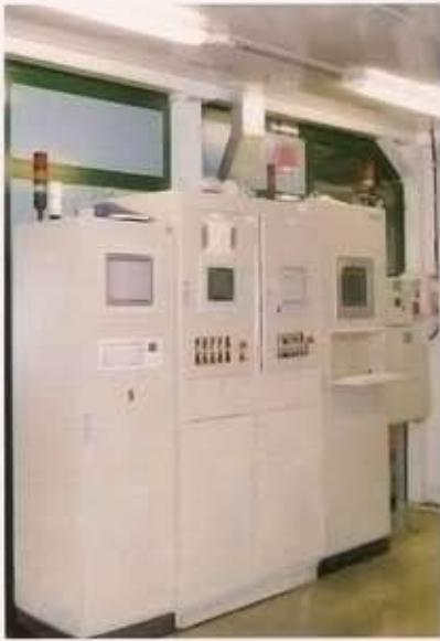
辊底炉生产线控制系统 Roller Hearth Furnace control System
